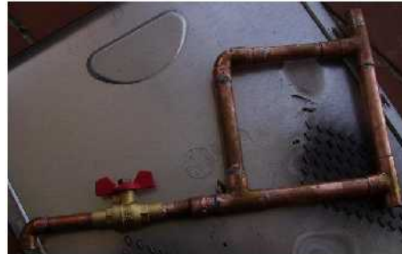
Tubería de cobre
