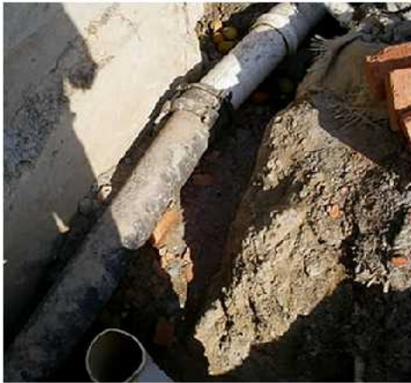
Tubería de PVC
