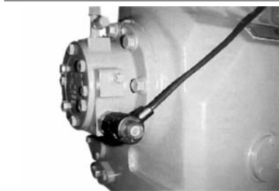
Figura 1.10 Control de presión diferencial de aceite montado en un compresor.
