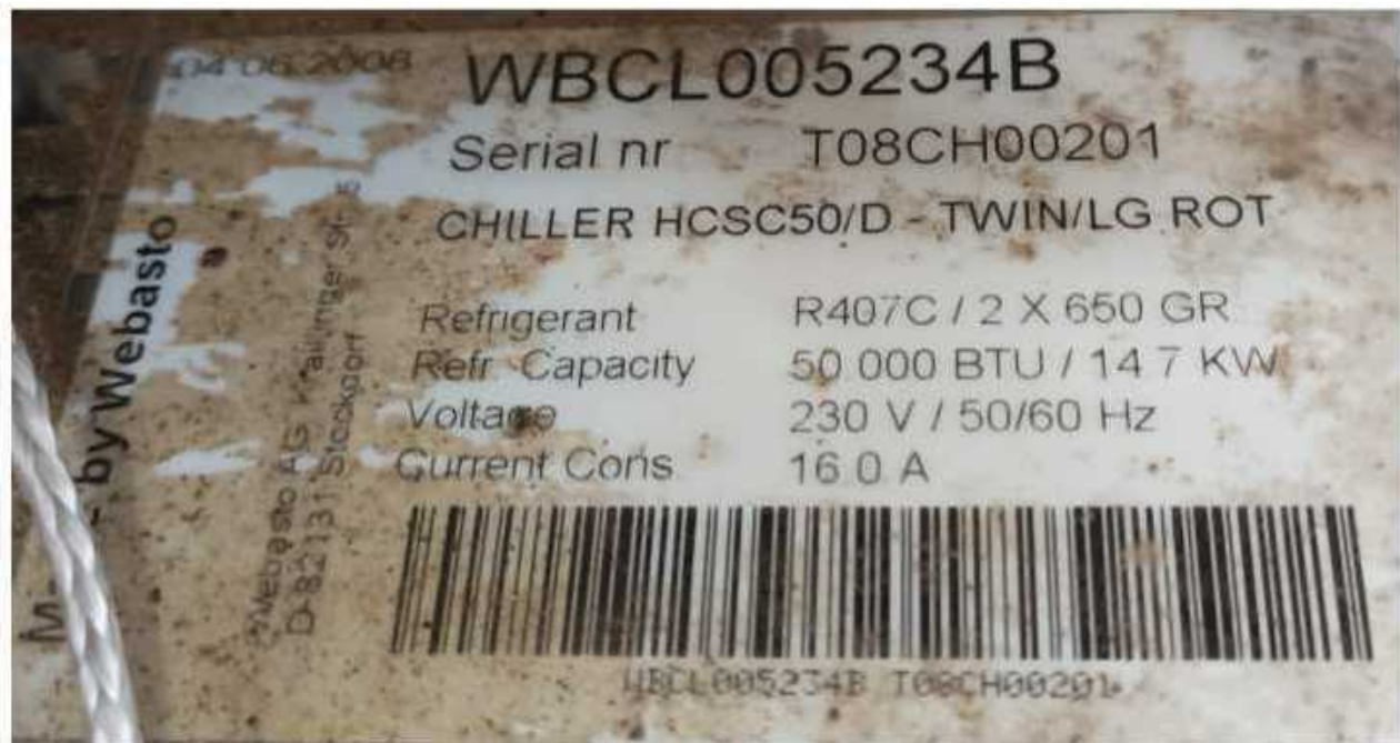
Imagen 4: Etiqueta de datos de la enfriadora del taller
